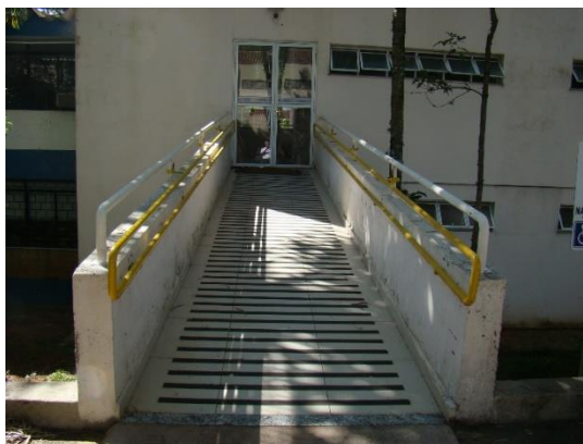
Bloco ICMC-3 - Corrimãos de rampa
