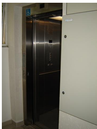
Vista do elevador - Bloco ICMC-3
