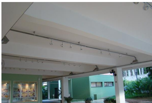
Figura 31 - Vista da Iluminação por Spots no Bloco ICMC-2
