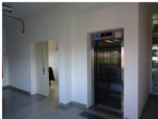
Figura 19 - Vista do elevador no 1º piso
