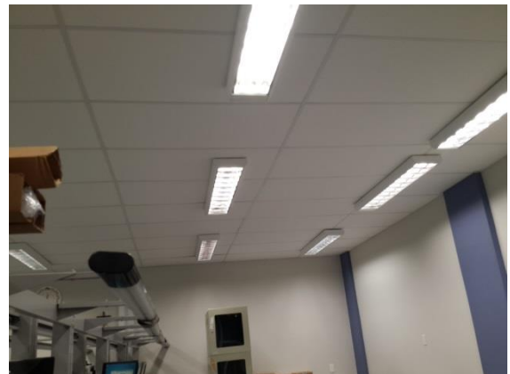
Figura 75 - Vista do forro da sala 1-003 e 1-005
