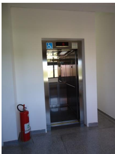
Figura 18 - Vista do elevador no piso térreo
