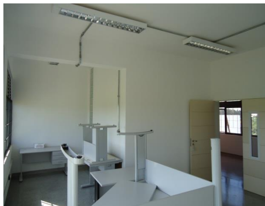
Figura 17 - Vista de Sala de Clusters
